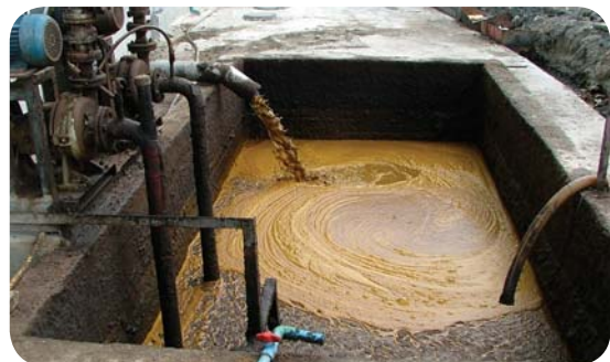
บ่อรับน้ำเสียจากกระบวนการผลิต มีปริมาณน้ำเสีย ประมาณ 240 ลูกบาศก์เมตรต่อวัน มีค่า COD 200,000 mg/l
