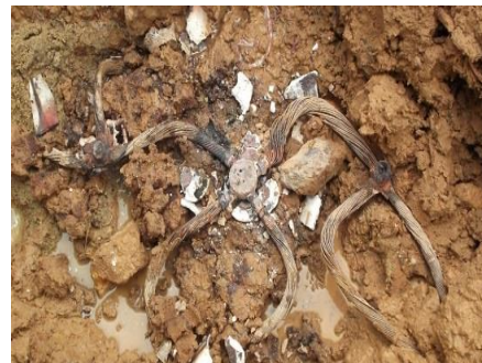
รูปที่ ๑๓ ติดตั้งตัวนำลงดินของระบบป้องกันอันตรายจากฟ้าผ่า
