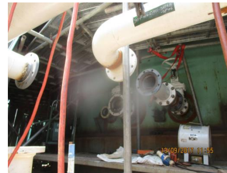
รูปที่ ๗ ติดตั้งหน้าแปลนและข้อต่อต่างๆ ที่ตัวถังเก็บน้ำมัน
