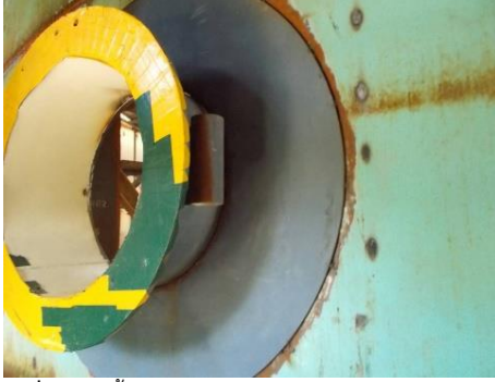
รูปที่ ๘ ติดตั้งช่องทางเข้าออก (Manhole)
