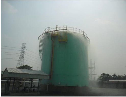
รูปที่ ๑๕ ทดสอบระบบดับเพลิง
