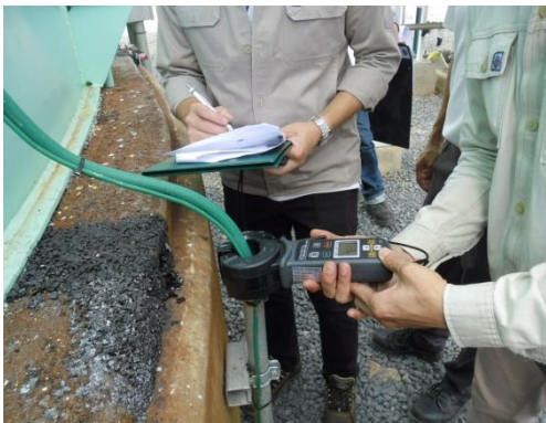
รูปที่ ๑๖ ตรวจสอบวัดค่าความต้านทานของตัวนำลงดิน
