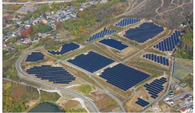
รูปที่ 2 แสดงโรงไฟฟ้าพลังงานแสงอาทิตย์
