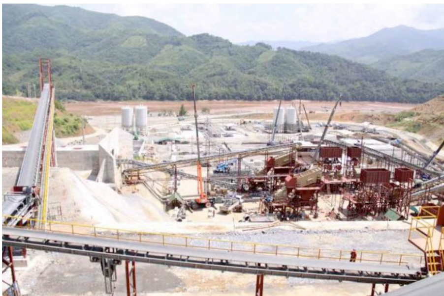
โรงไฟฟ้าไซยะบุรี / Xayaburi Power Plant
